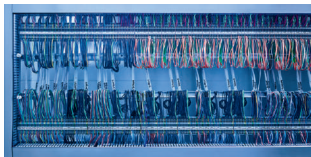
Ein modernes Haus mit allem technischen Komfort verlangt auch perfekt funktionierende Elektronik.
